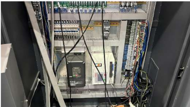
Применяемая электрика в шкафах управления
