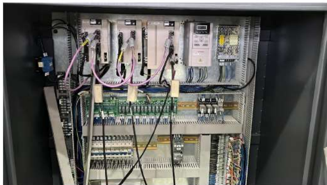
Применяемая электрика в шкафах управления
